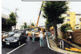
2013年7月 垂水区向陽で、照明柱が老朽化により倒壊しました。
